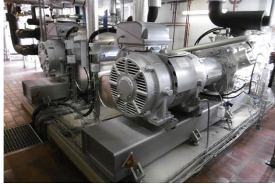
Verdichter der Kälteanlage Eglisee
