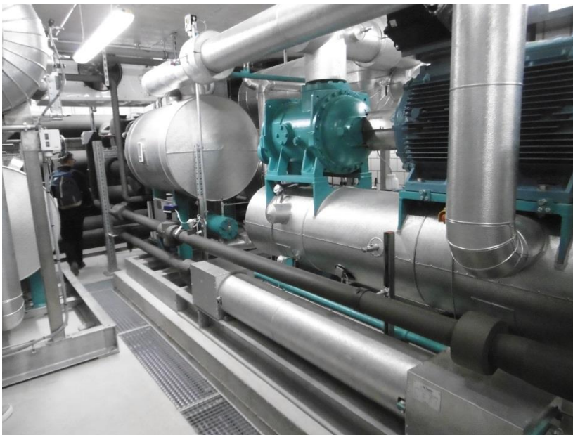
Ammoniak-Anlage für die Klimatisierung in einem eigenen Maschinenraum
