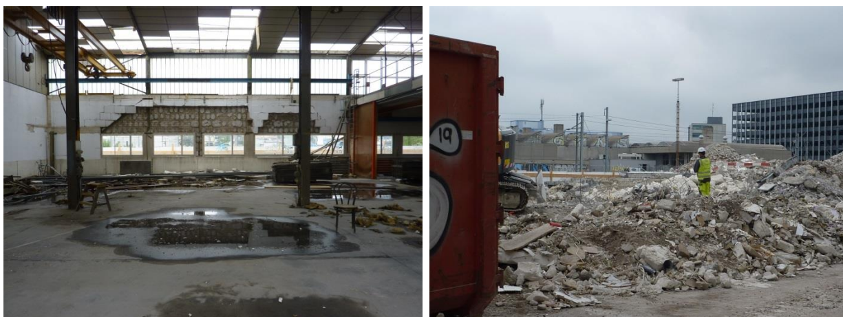
Fotos 4: Auch auf Baustellen gibt es Wasseransammlungen, die der Tigermücke als Brutstätte dienen können.
