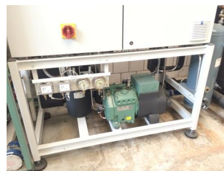
Für Kälteanlagen und Wärmepumpen besteht eine Meldepflicht und das Führen eines Wartungshefts und eine regelmässige Dichtigkeitsprüfung sind erforderlich.
