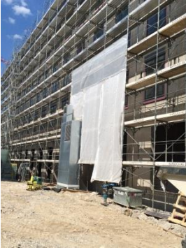
Zwischenlösung für die Raumentlüftung der Ammoniak-Wärmepumpe an der Fassade des noch nicht bewohnten Wohnblocks
