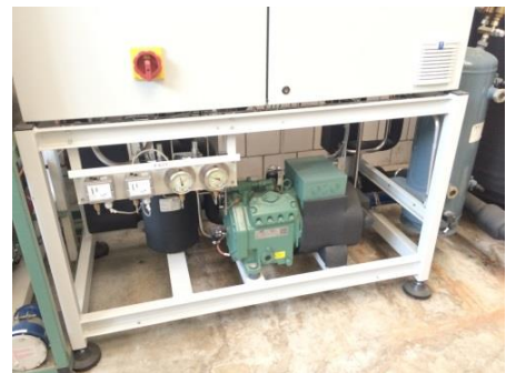
Für Kälteanlagen und Wärmepumpen besteht eine Meldepflicht und das Führen eines Wartungshefts und eine regelmässige Dichtigkeitsprüfung sind erforderlich.
