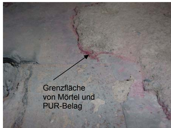
Bild 2: Rotfärbung der unteren Mörtelschicht
