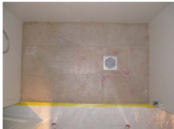
Bild 1: Rotfärbung der Fliesen der Dusche
